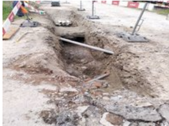
Böse Überraschung: Leitungen sind leider nicht immer korrekt im Kataster eingetragen.
