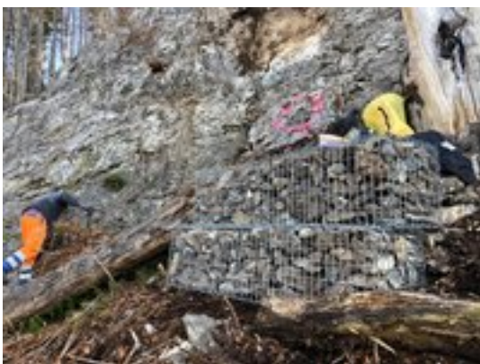
...wird in Steinkörben deponiert. So wird verhindert, dass die Steine erneut mobilisiert und somit zu einer Gefahr für die Bahnlinie werden können.
