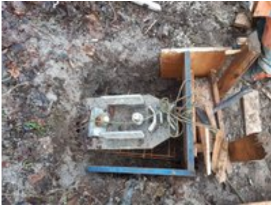
Schalung für ein Betonfundament, auf welchem eine Stütze des Netzes zu stehen kommt. Die Betonfundamente dienen als Erosionsschutz.
