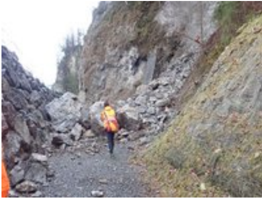
Erstbeurteilung nach den Ereignissen vom 28.01.2021. Das Sturzmaterial hat sich hinter dem Damm abgelagert.
