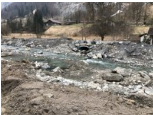
Einbau von Raubäumen und Blöcken im Gerinne. Erstellung von Kleinstrukturen im Uferbereich.
