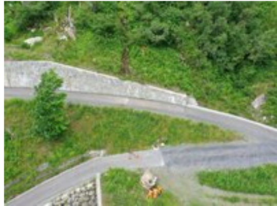
Erstbeurteilung nach Blockschlag auf die Schöllenenstrasse (Bild: Bundesamt für Strassen ASTRA)
