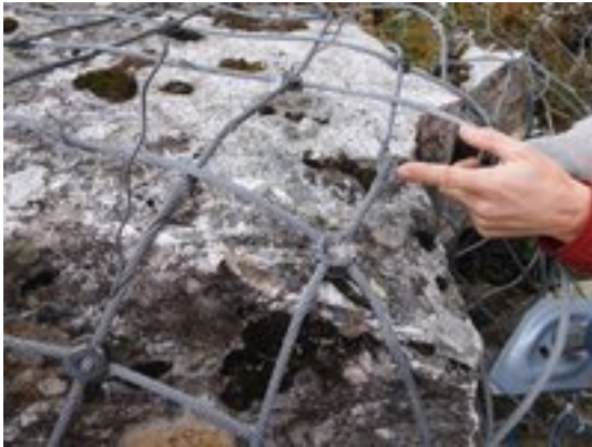
Beurteilung eines Defekts an einer Netzabdeckung
