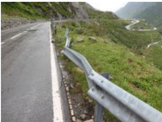
Erstbeurteilung nach Stein-/Blockschlag auf die Strasse, welcher die Leitplanken beschädigt hat
